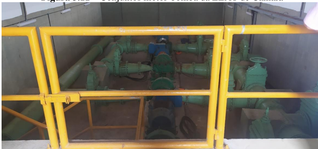
Figura 3.11 – Conjuntos motor-bomba da EEAT de Camará
