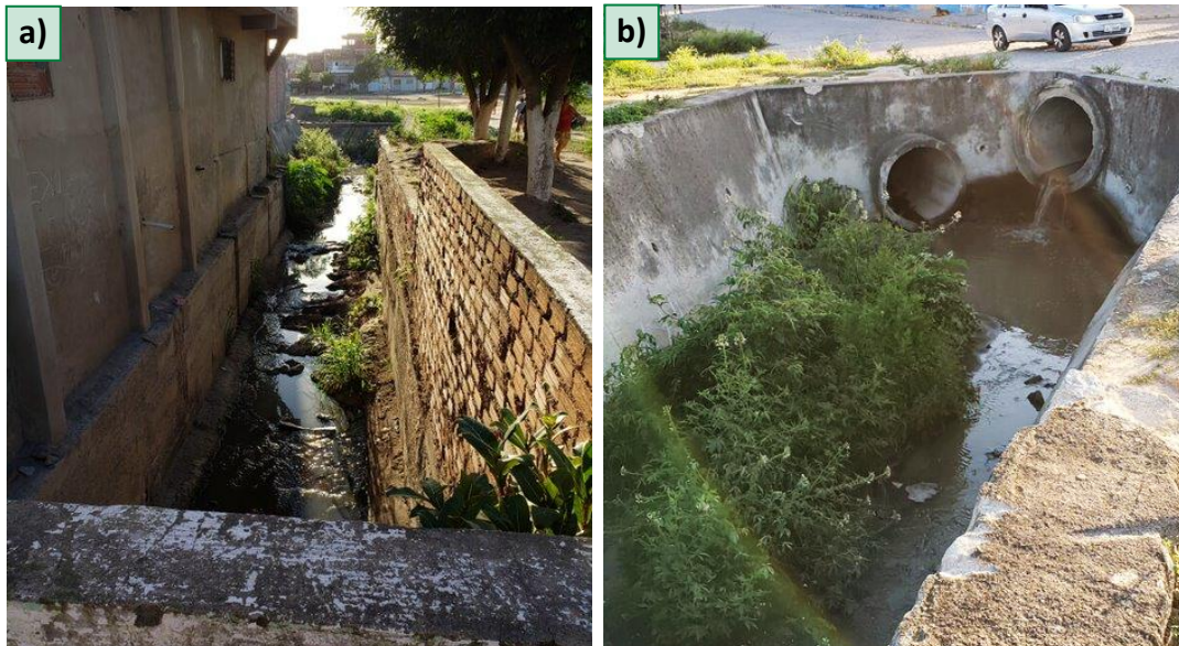
Figura 5.30 – Tubulações de esgoto das residências (a) e despejo de esgoto das galerias (b) no Canal Banabuiê
