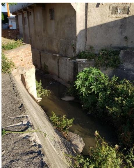
Figura 4.24 - Canal de drenagem que recebe contribuições de esgoto no Distrito Sede
