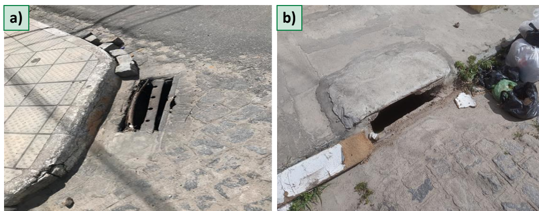
Figura 5.10 – Bocas de lobo pertencentes ao sistema de drenagem da zona urbana de Esperança: com patologias estruturais (A) e sem proteção sanitária (B)
