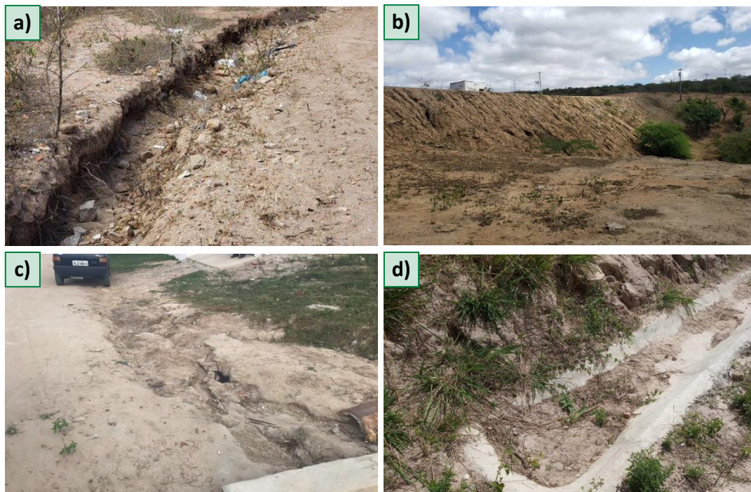
Figura 5.40 – Sulcos em estrada vicinal entre a sede e o Povoado Massabiele (Coordenadas: -6.974299, -35.898204) (a); erosão em barramento do Açude Massabielle (b); rua não pavimentada no Conjunto 40 (c); erosão em terreno da avenida 1º de Dezembro (d)
