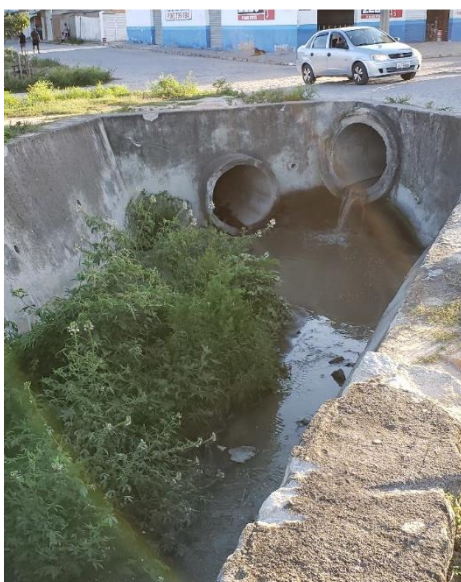
Figura 4.25 - Lançamento de efluentes no canal de drenagem do Distrito Sede
