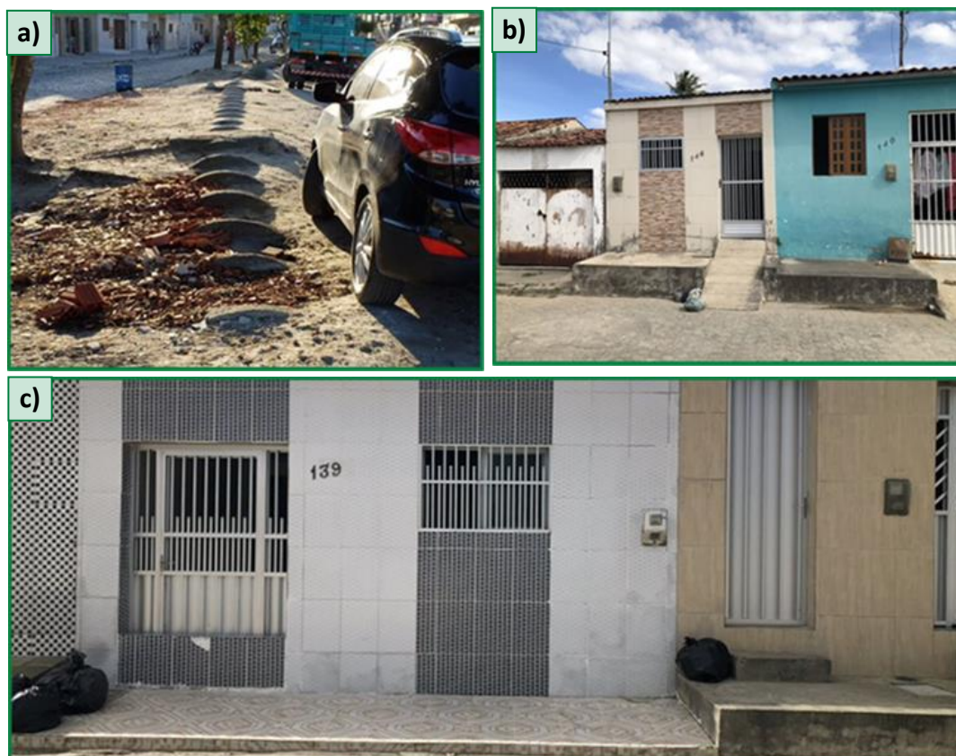
Figura 5.35 – Tubulação exposta na rua Joaquim Manoel (a) e estratégias de mitigação encontradas na rua Francisco Vitorino Duarte (b e c)
