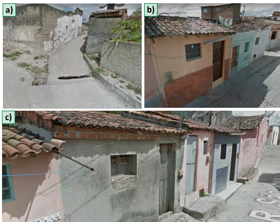
Figura5.34 – Boca de lobo improvisada pela população (a) e dispositivos de mitigação na rua São José (b e c)
