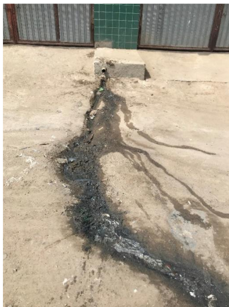
Figura 4.15 - Esgoto a céu aberto na rua Beto Nascimento
