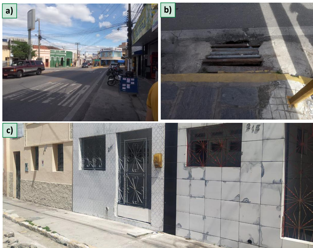
Figura 5.32 – Cruzamento entre as ruas Antenor Navarro e Joviniano Sobreira (a), dispositivos de drenagem (b) e medidas de mitigação adotadas pela população (c)
