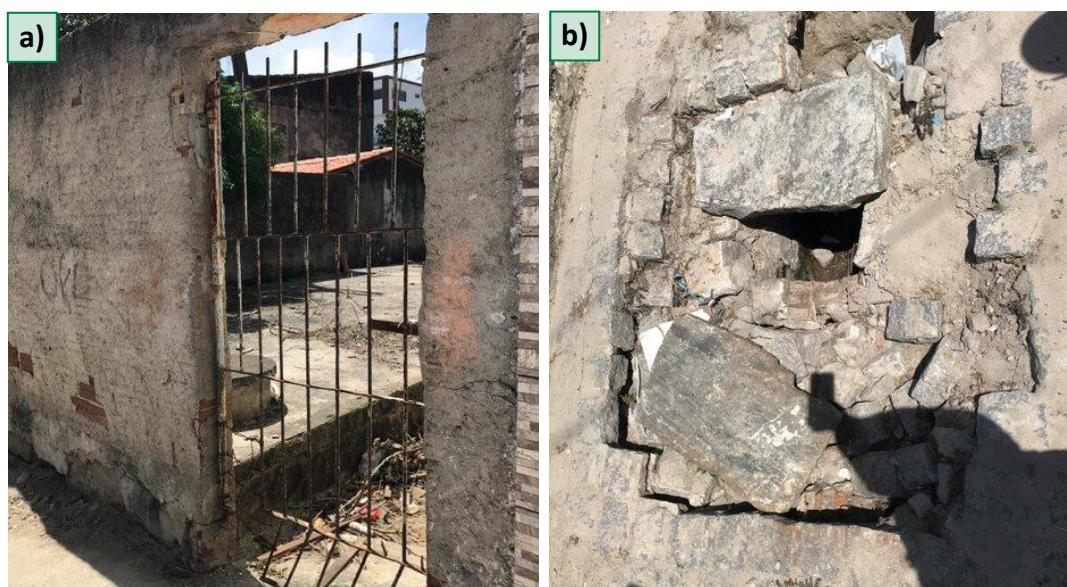
Figura 5.29 – Fossão (a) e boca de lobo (b) localizada na Rua José Bonifácio
