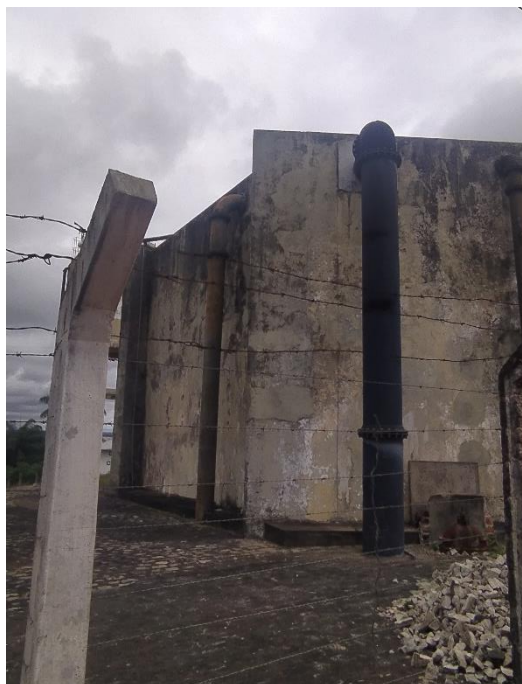
Figura 3.12 – Reservatório de Cepilho
