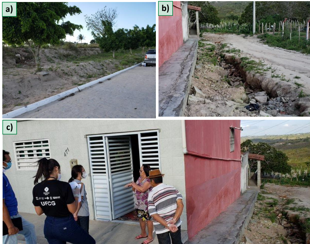
Figura 5.36 – Aterro do campo de futebol (a), ruas com sinais de erosão (b) e casas que eram afetadas pelas chuvas (c)
