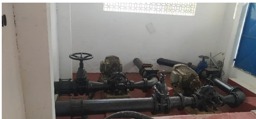
Figura 3.13 – Conjuntos motor-bomba da estação elevatória Pomaré
